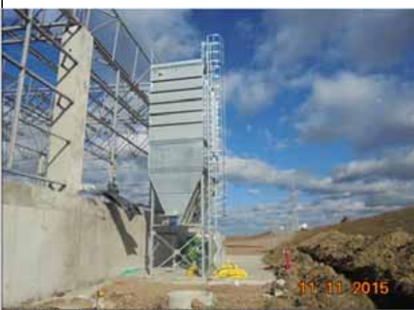
Echipamente Statie Sortare.
