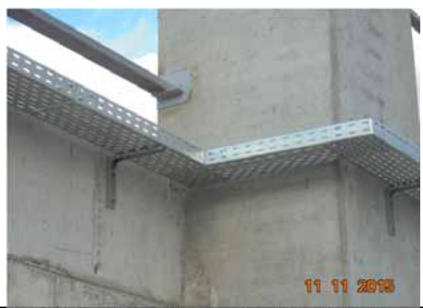
Jgheaburi pentru cabluri electrice, Statie Sortare.
