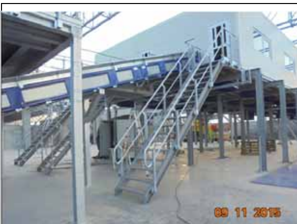
Scari metalice si cabine comanda, Hala Tratate Biologica.
