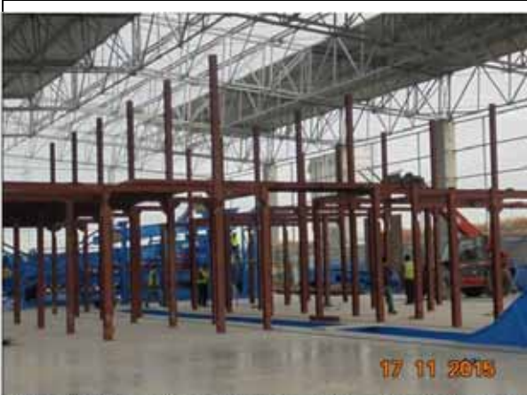
Structura metalica sustinere cabine, Statie Sortare.
