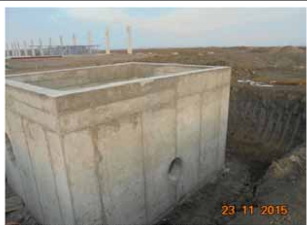
Deznisipator 2, Hala Tratate Biologica.
