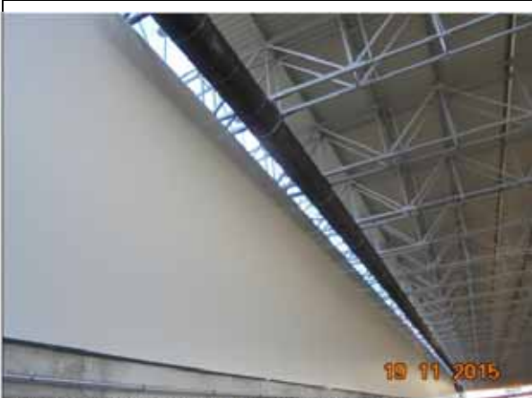
Tuburi ventilatie Hala Tratate Biologica.
