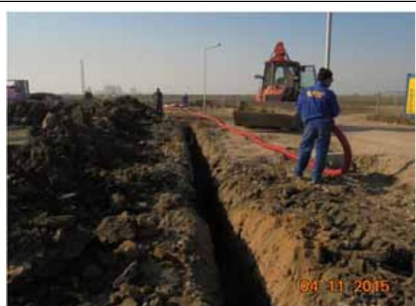
Pozat cabluri electrice.
