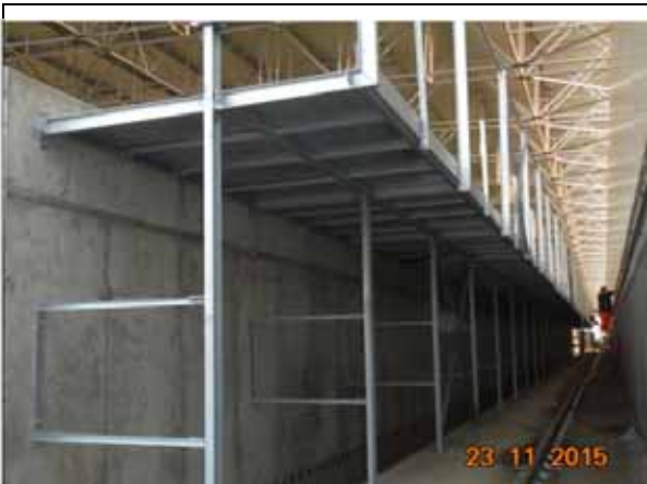
Structura metalica sustinere banda de incarcare, Hala Tratate Biologica.
