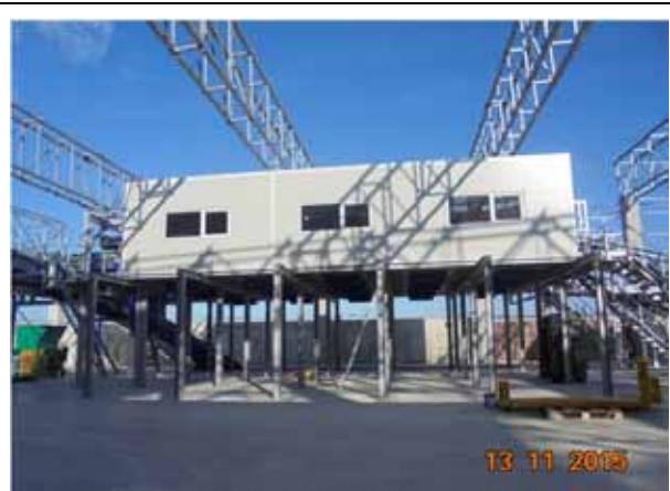
Cabina statie sortare, Hala Tratare Biologica.
