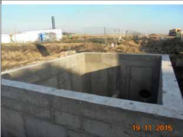
Deznisipator 1, Hala Tratate Biologica.
