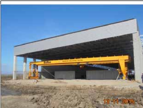
Biomax 1, Hala Tratare Biologica.
