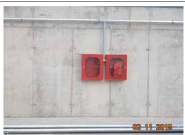
Instalatie hidranti, Hala Tratare Biologica.
