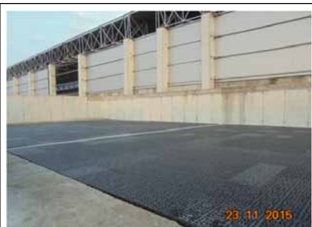
Gratare plastic pentru dispersia aerului Biofiltru nr.1.
