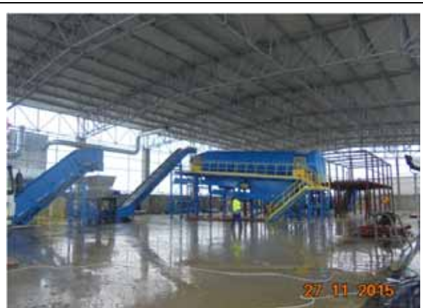
Echipamente Statie Sortare.
