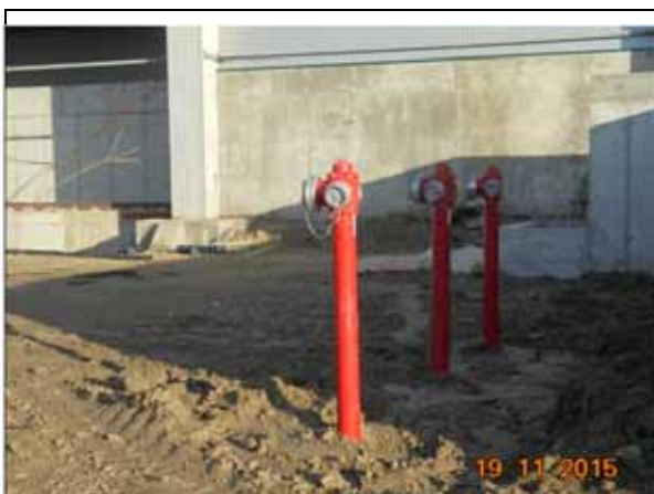
Hidranti exteriori, Biofiltru 2.
