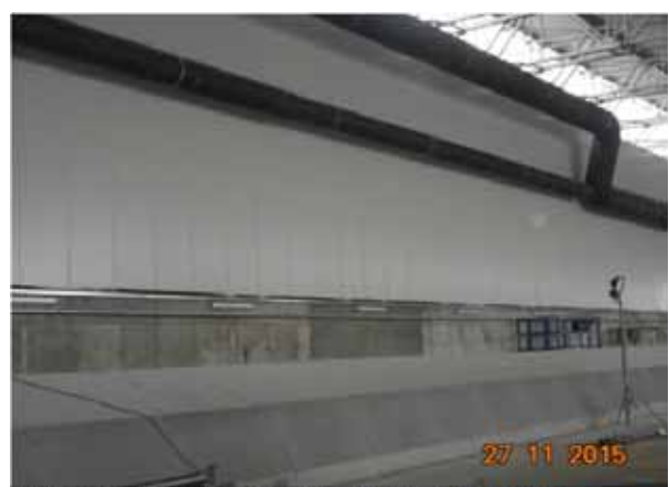
Tubulatura ventilatie, Hala Tratate Biologica.
