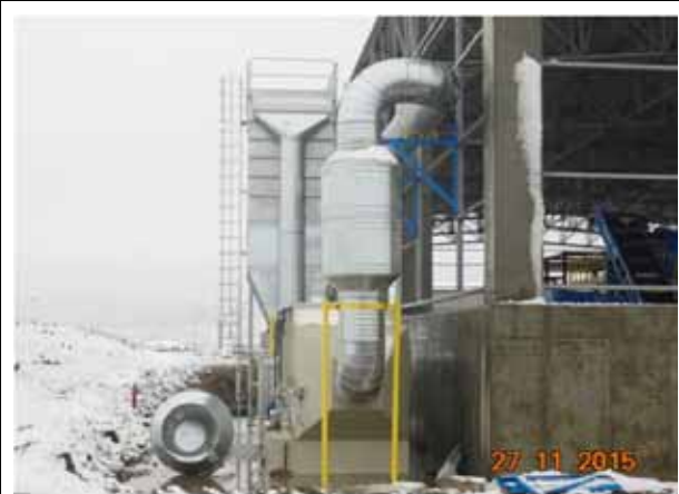
Echipamente Statie Sortare.
