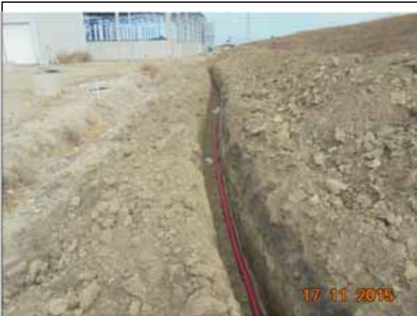
Pozare cabluri electrice Statiei de Sortare-Statie Tratate Mecanica.
