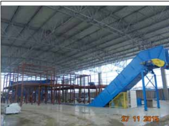
Echipamente Statie Sortare.
