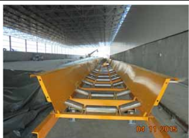
Banda transportoare, Hala Tratate Biologica, ax E.
