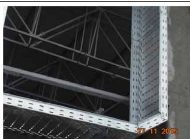
Jgheaburi pentru cabluri electrice, Hala Tratate Mecanica.
