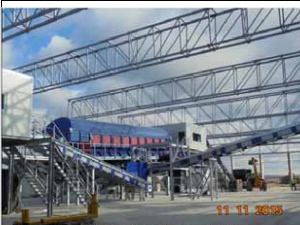
Echipamente Stadler, Hala Tratare Biologica.
