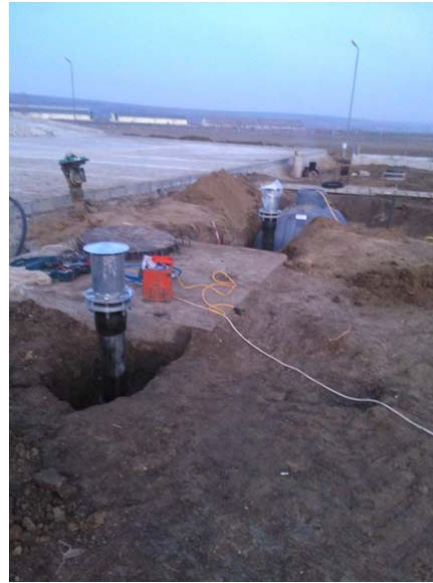
Statie pompare hidrofor, rezervor apa potabila
