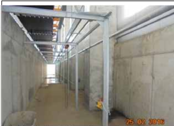
Montat pat de cabluri pentru banda transportoare + instalatia electrica pentru butonul de urgenta, Hala Maturare.
