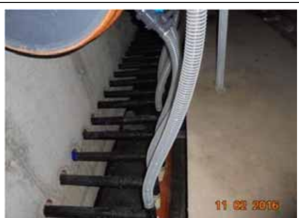
Racorduri tubulatura ventilatie negativa in spatele reactorului, Hala Tratate Biologica.
