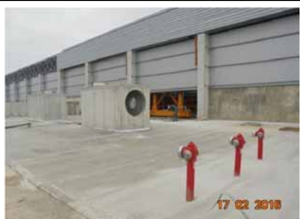
Platforma pentru instalațiile de ventilație între Biofiltre.
