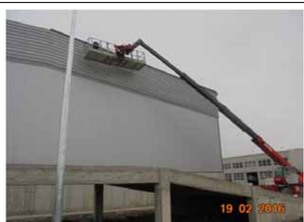
Montare coltare, Statia de Sortare.
