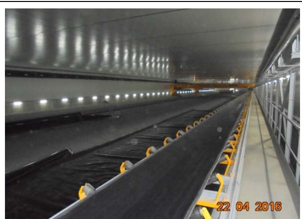
Pregatire pentru teste, Hala Tratare Biologica
