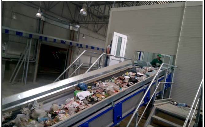
Funcționare cu deșeuri bandă transportoare de sortare manuală pentru fracția 80-300 mm
