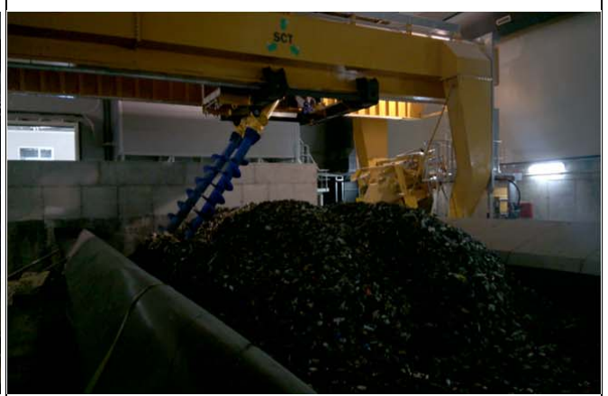
Echipamentul Biomax mută cele 3 șiruri în reactor
