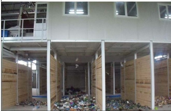
Deșeuri sortate pe categorii în silozurile de sub cabinele de sortare
