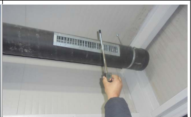
Măsurare flux aer instalații ventilație Cabine Sortare
